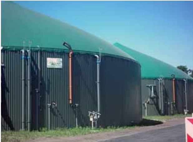
Fermenter einer Biogasanlage
